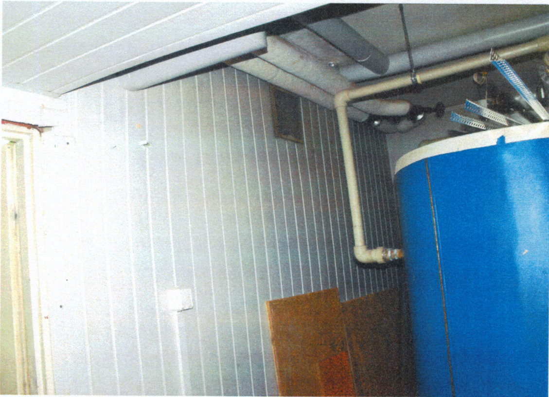
Zdjęcie nr 6 podłączenie wentylacji z pomieszczenia byłej kotłowni do komina w poziomie piwnic.
